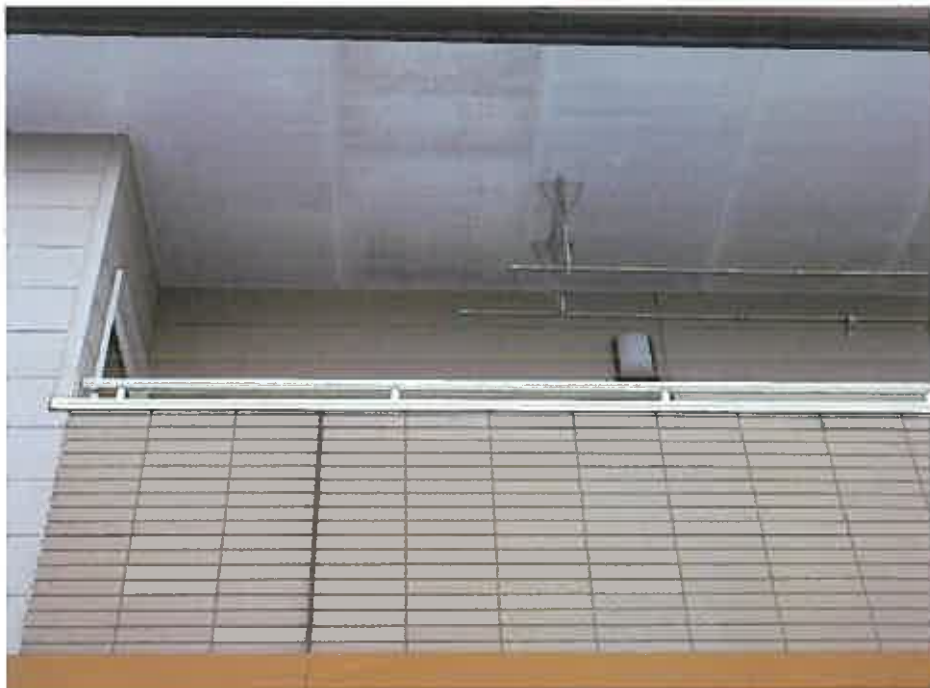
物件3:2階屋根の軒天の汚損等の状況
