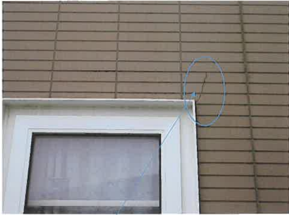
物件3:外壁のひびの状況
