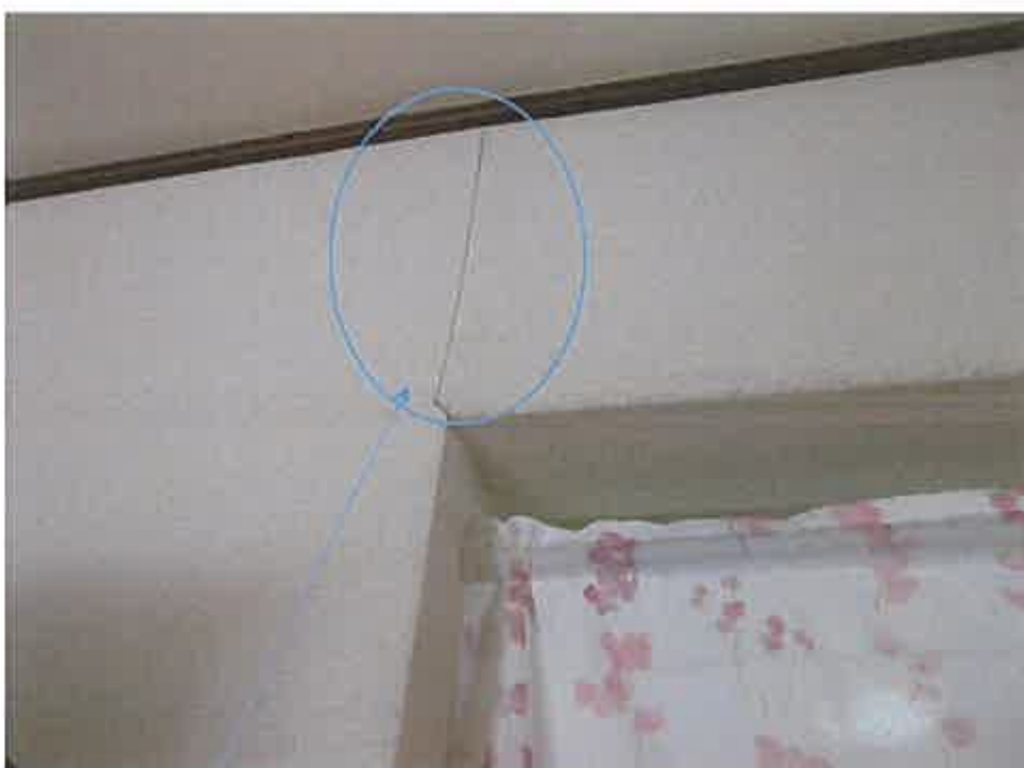
物件3:1階台所の内壁クロスのひびの状況
