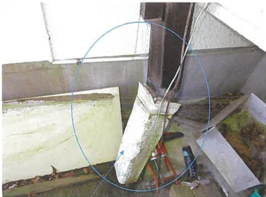
カーポートの支柱の歪み
