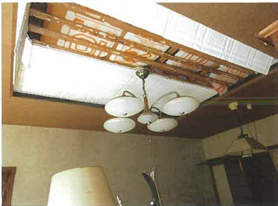
物件2:主である建物1階洋間の天井の破損状況
