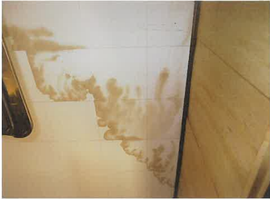
物件2:主である建物1階台所の天井のシミの状況
