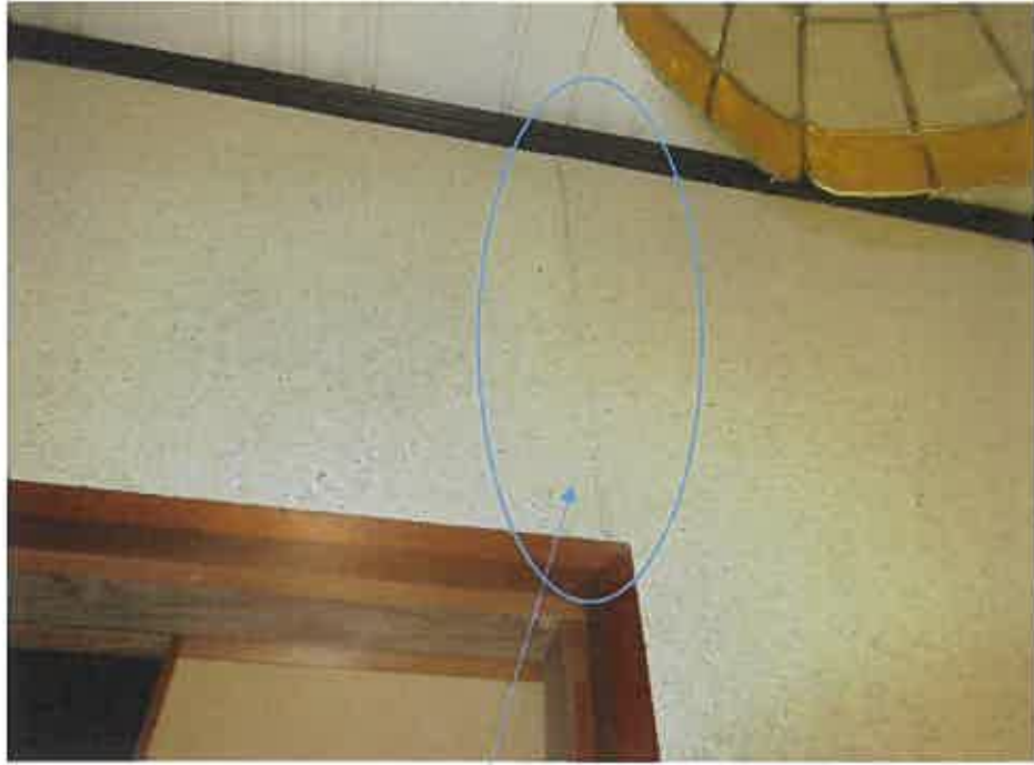
物件2:主である建物2階廊下の内壁のひび
