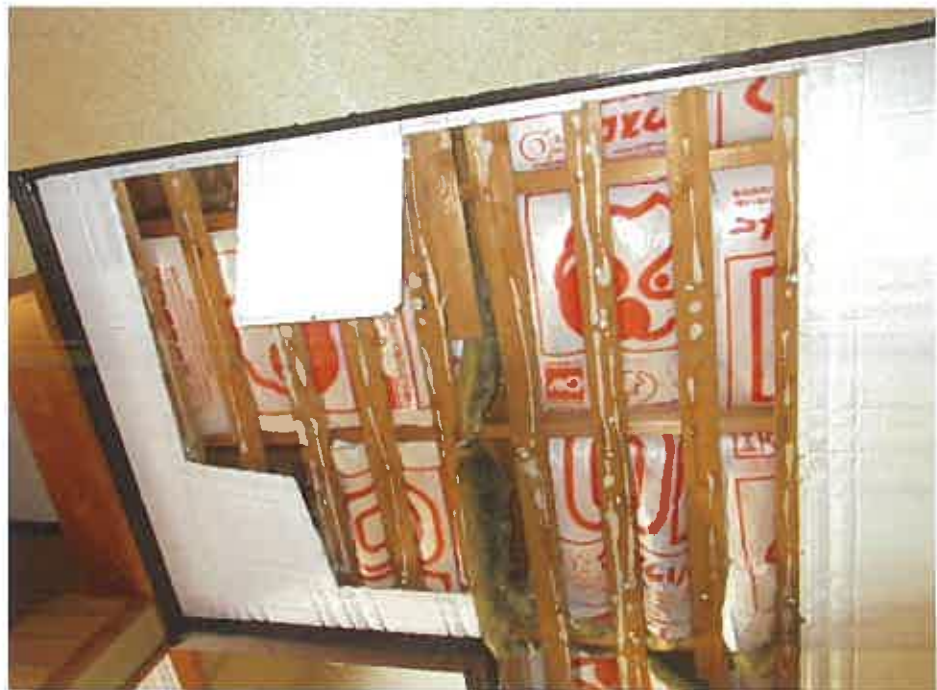
物件2：主である建物1階ホールの天井の破損状況
