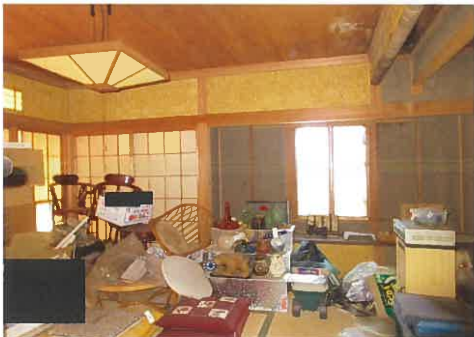
物件2:主である建物1階西側和室の状況
