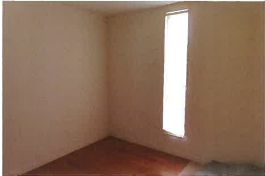
物件2:2階南東側洋間の状況
