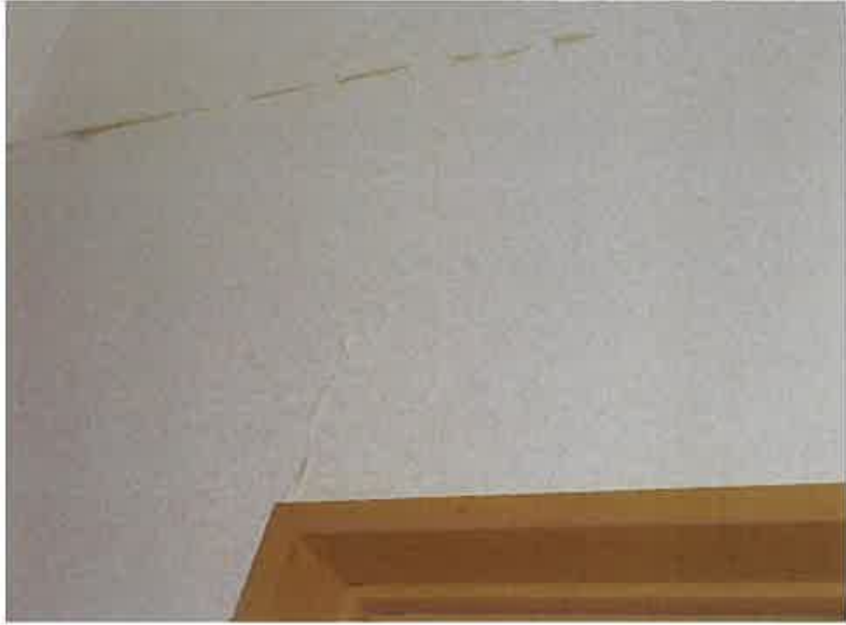
物件3:1階脱衣所の内壁クロスのひび等の状況 No. 15
