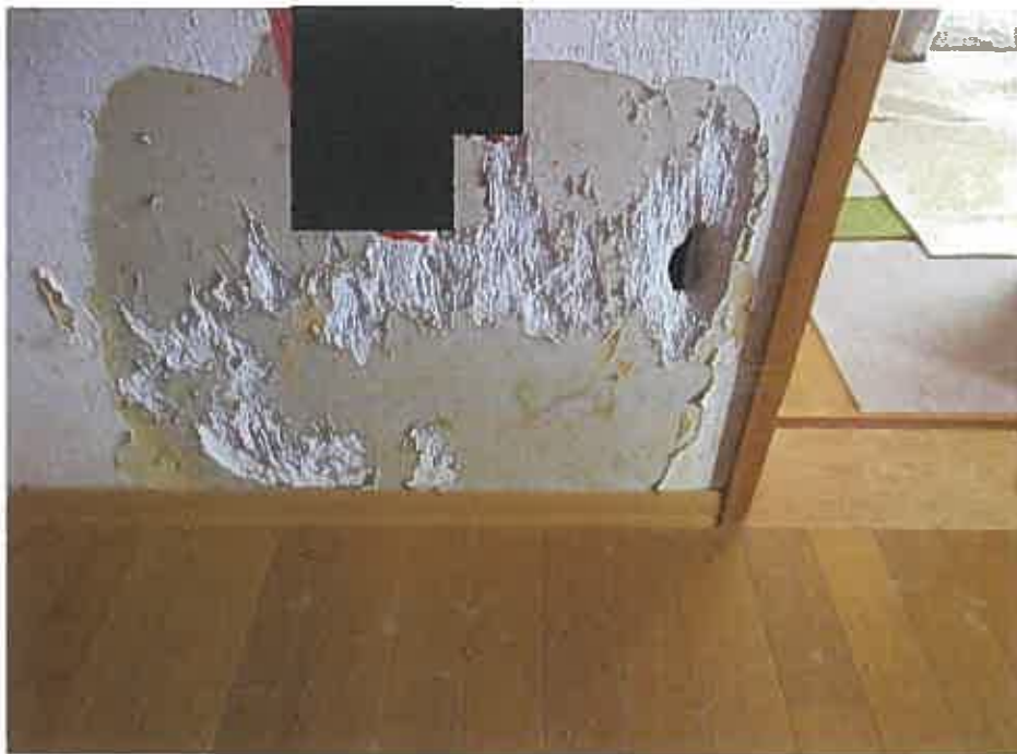
物件3:1階ホールの内壁の損傷等の状況
