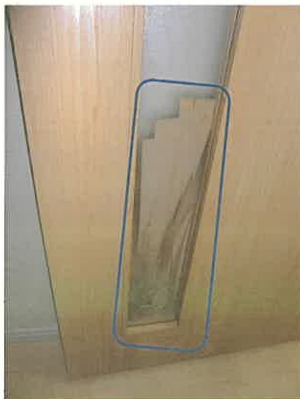
写真 6 2階納戸入口ドアの損傷状況
