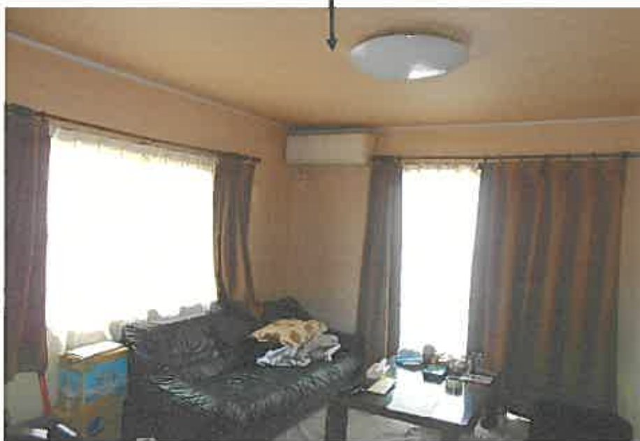
変色した天井・壁
