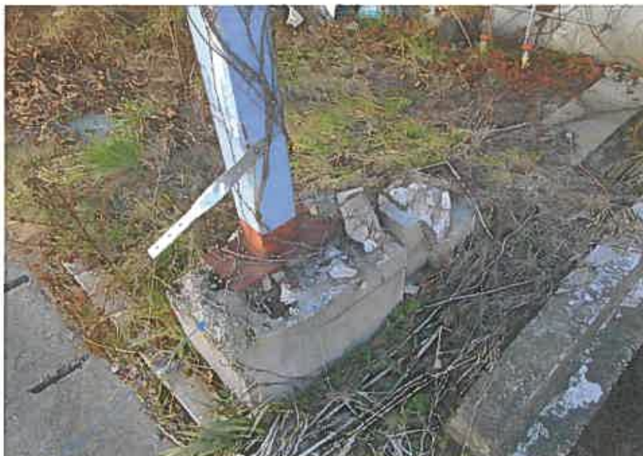
外階段の支柱の破損
