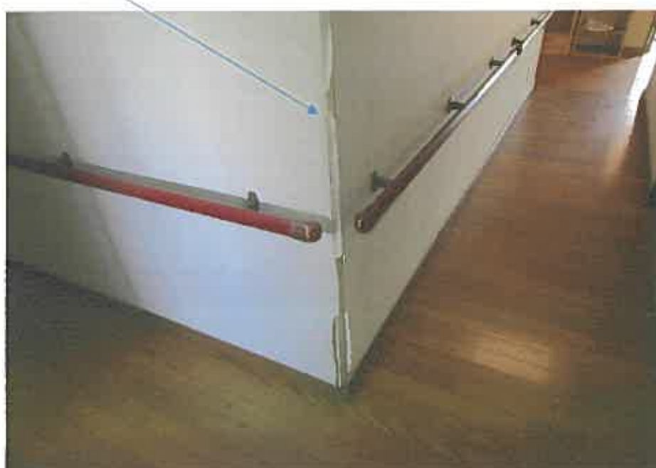
写真⑱ 内壁クロスの損傷
