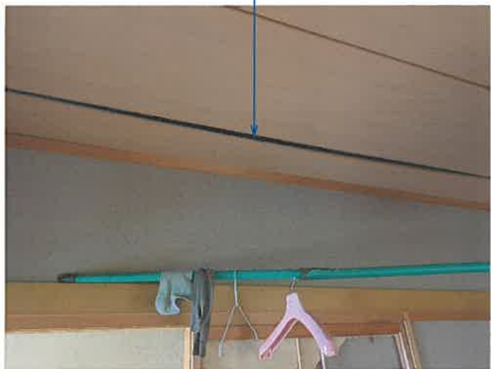
写 真 4 天井の隙間
