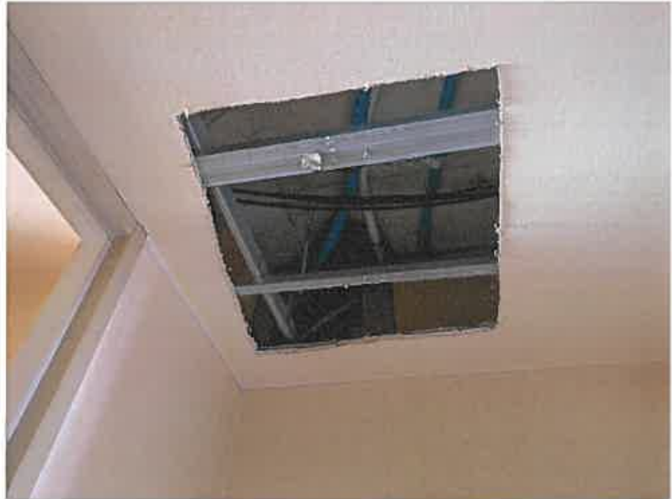
写 真 5 くり抜かれている天井の一部
