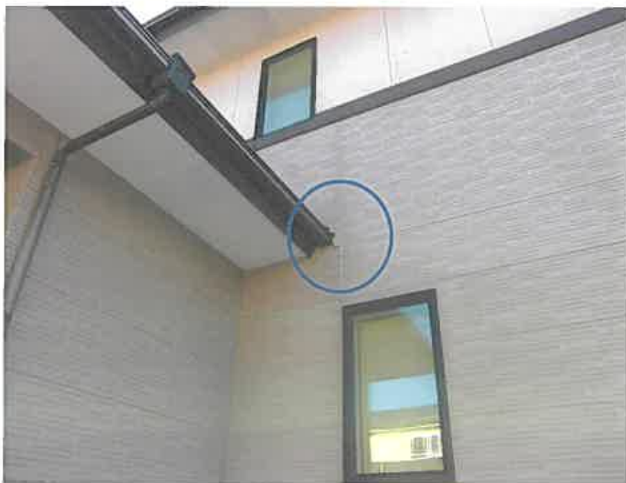
写真 6 雨樋と外壁サイディング取り合い部分の破損状況
