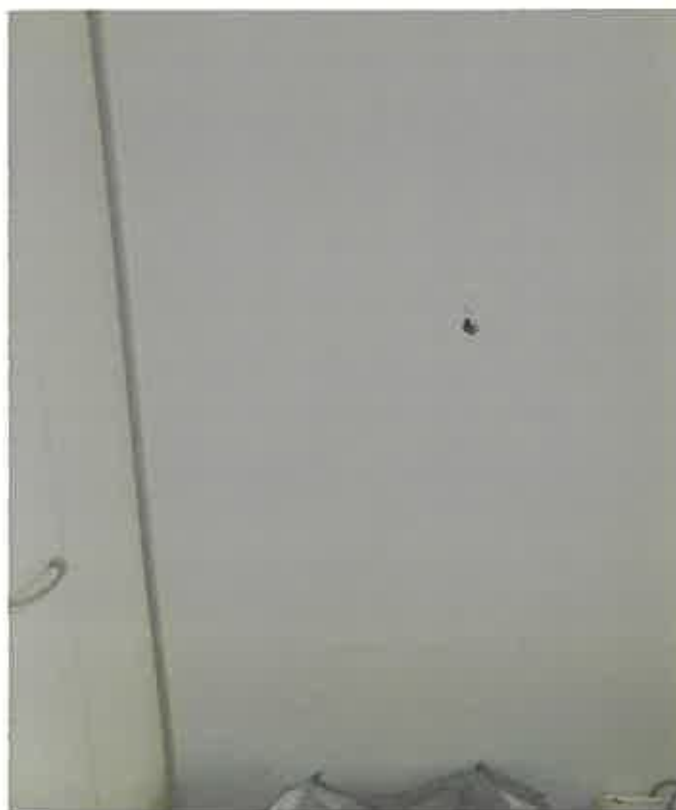
二階北東側洋室内壁の破損箇所
