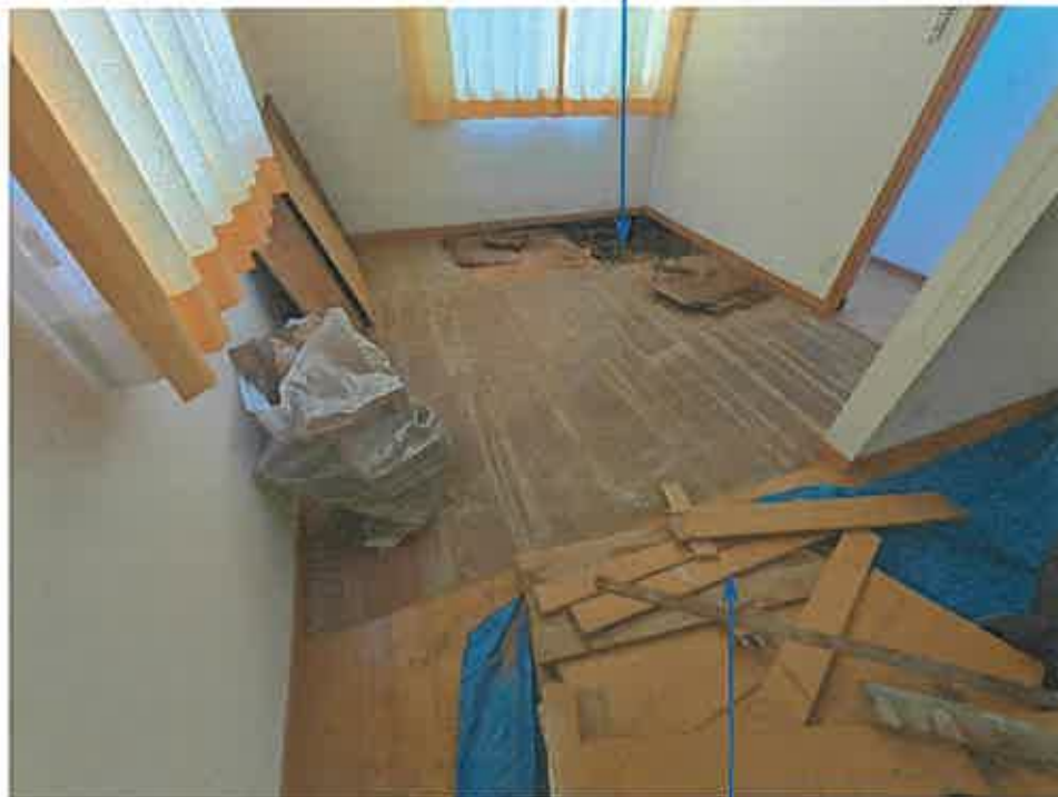
取り払われたままの床板
