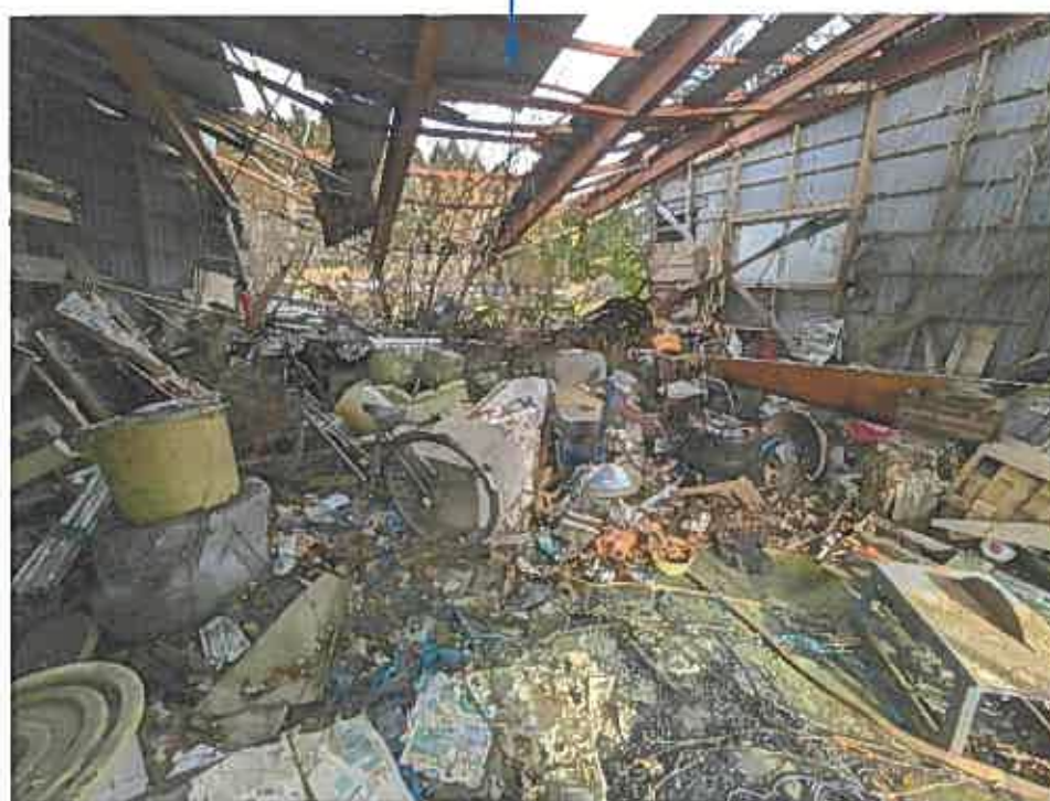
写 真 1 0 損壊している物件 4 の屋根
