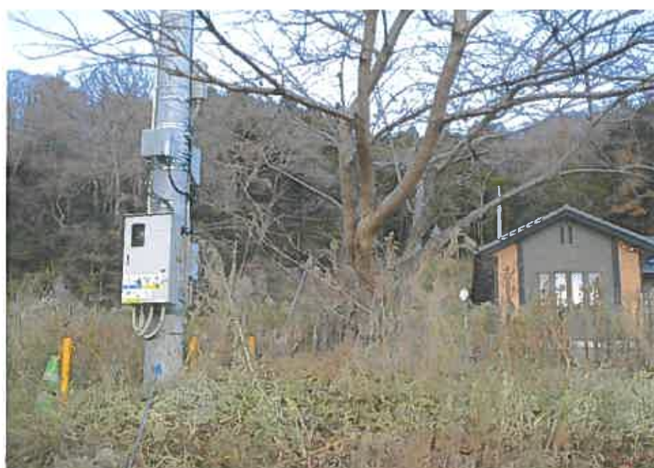
基地局アンテナ
