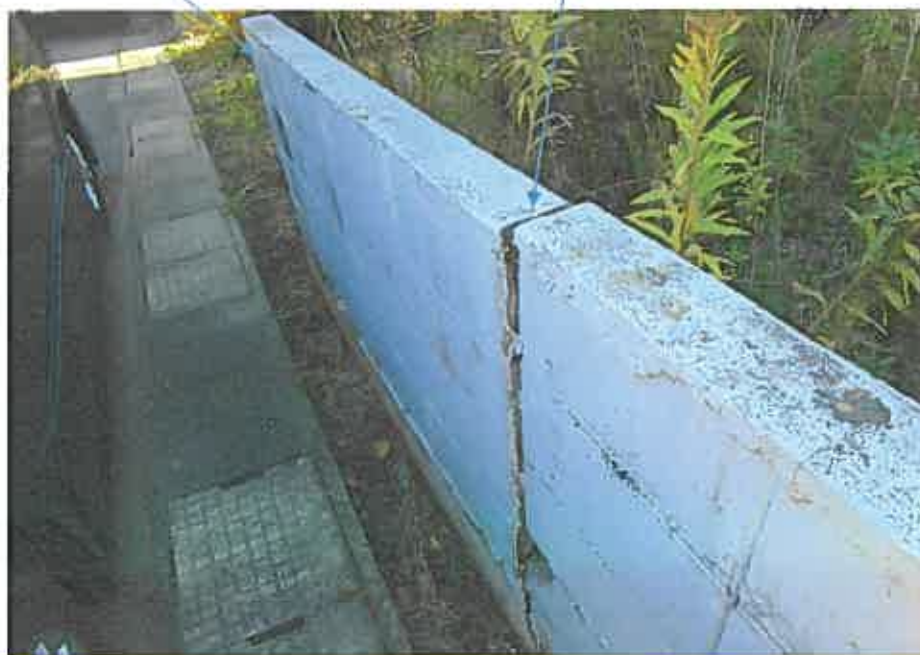
写真④ コンクリートブロック塀 亀裂
