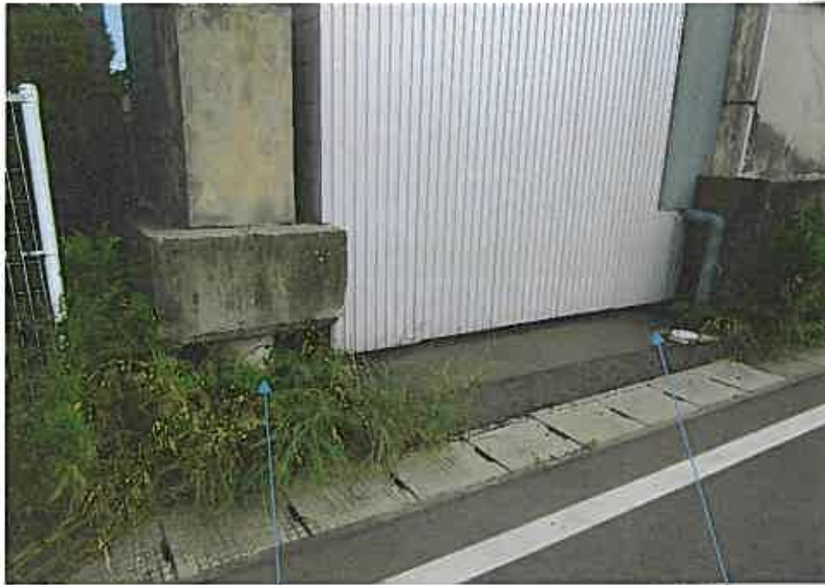
地盤沈下によるパイルの浮き上がり 物件2
