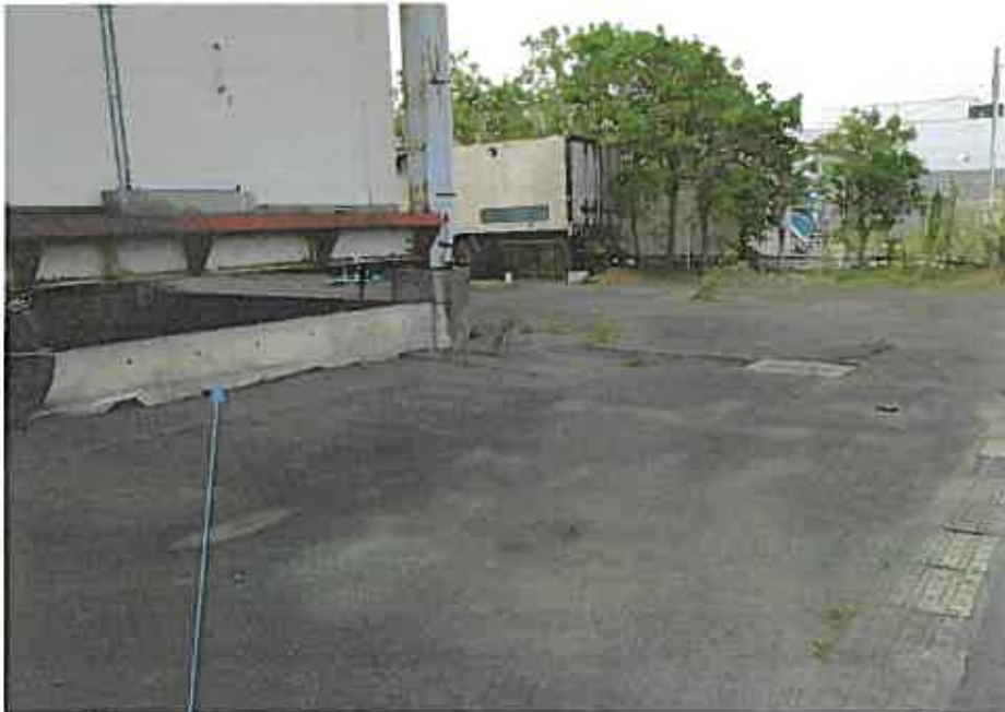
地盤沈下の形跡(黒い線が元々の地盤)
