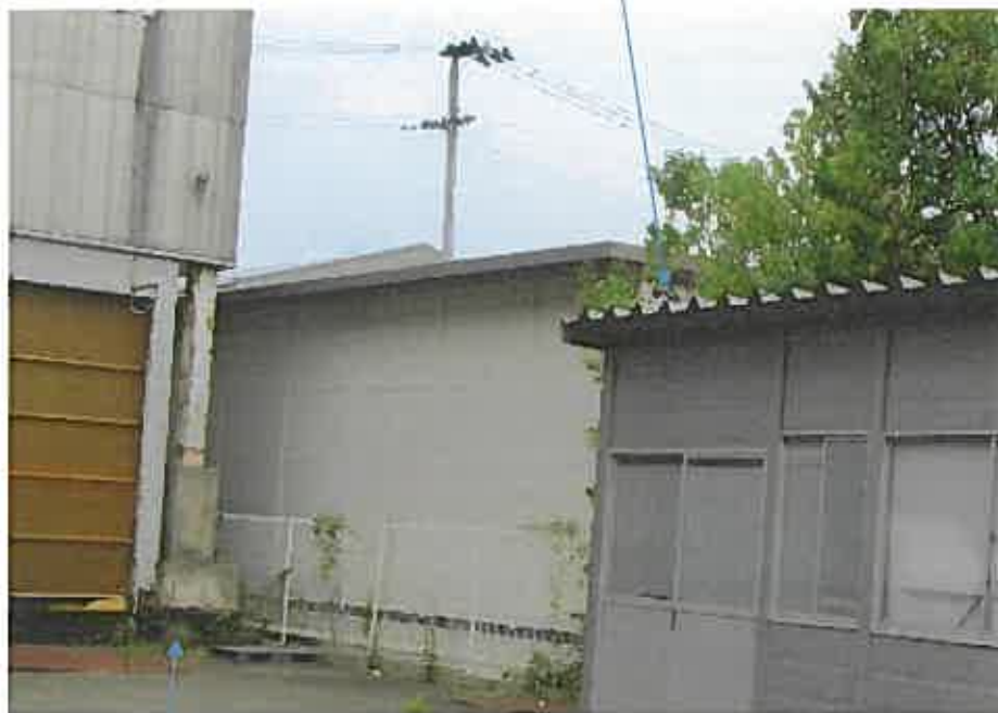
地盤沈下によるパイルの浮き上がり
