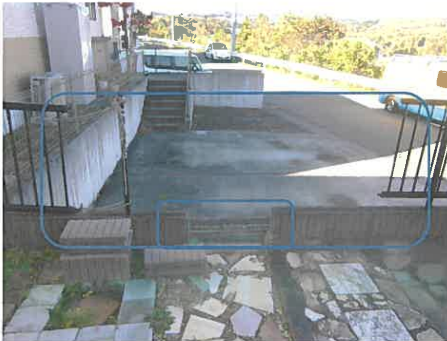
写真 8 ブロック塀及びフェンスの破損状況
