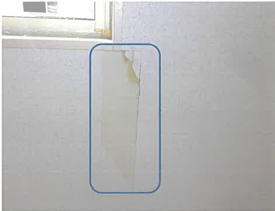
写真 7 内壁の破損状況
