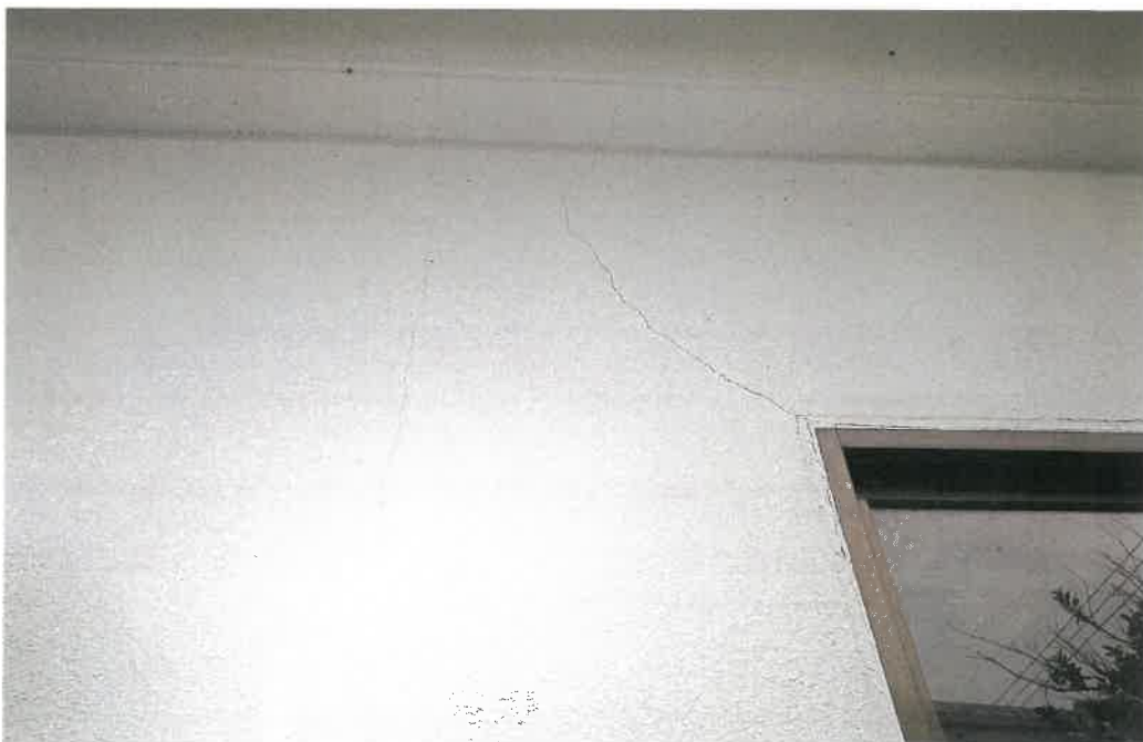
物件3 (外壁コンクリートのクラック)
