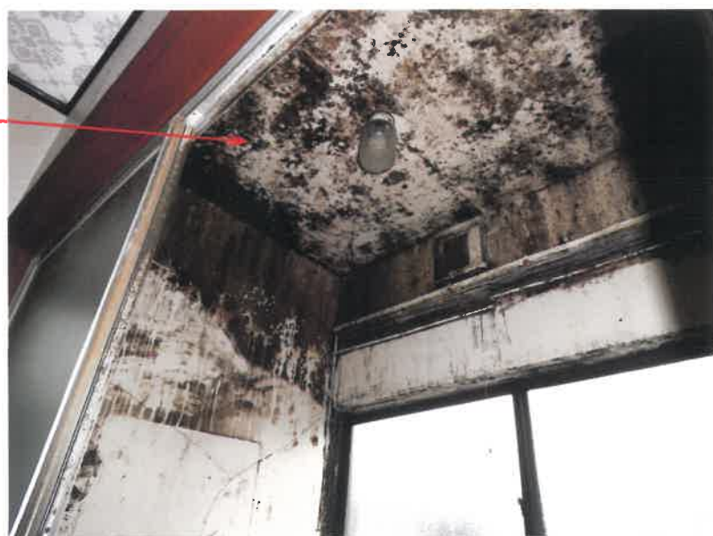
カビによる汚損箇所
