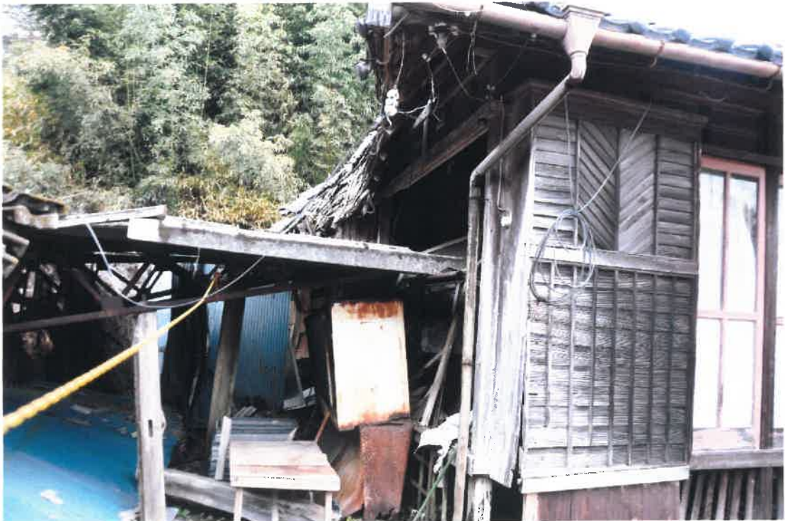
写真⑩ 主たる建物屋根と壁の崩落
