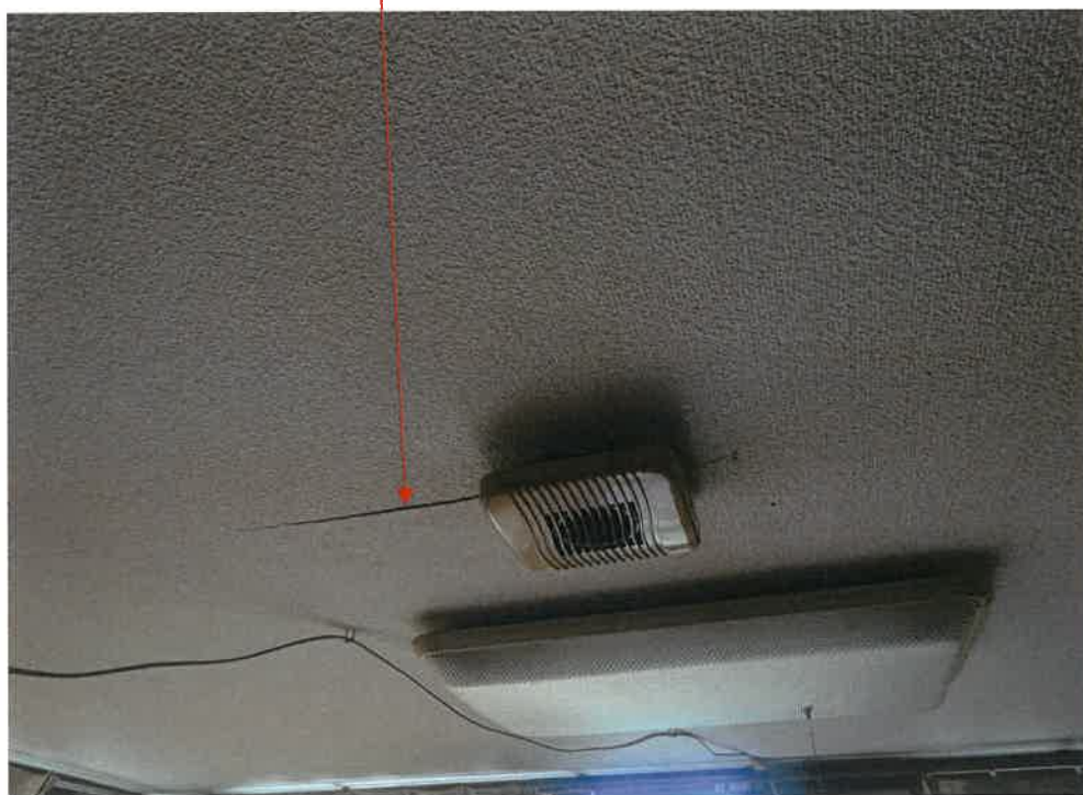
天井材の割れ
