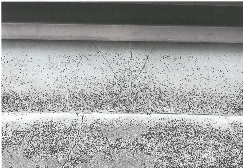
基礎・犬走のひび割れ
