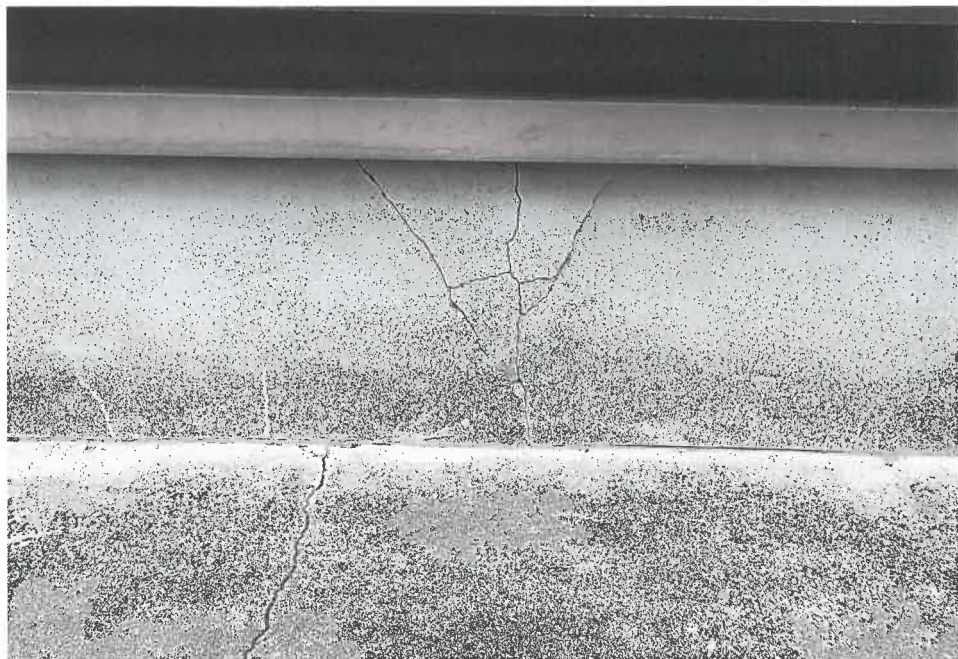
基礎・犬走のひび割れ
