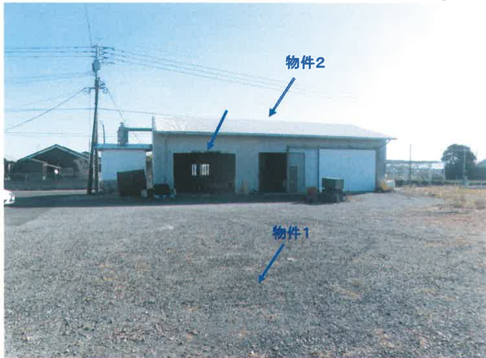
損傷部分の様子
