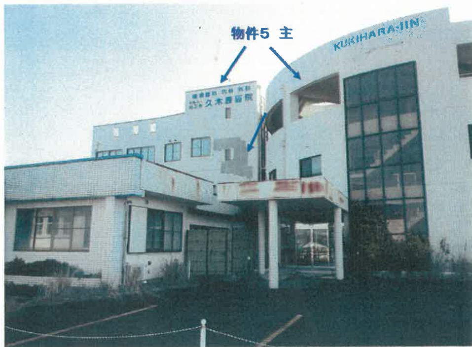
外壁の破損の様子
