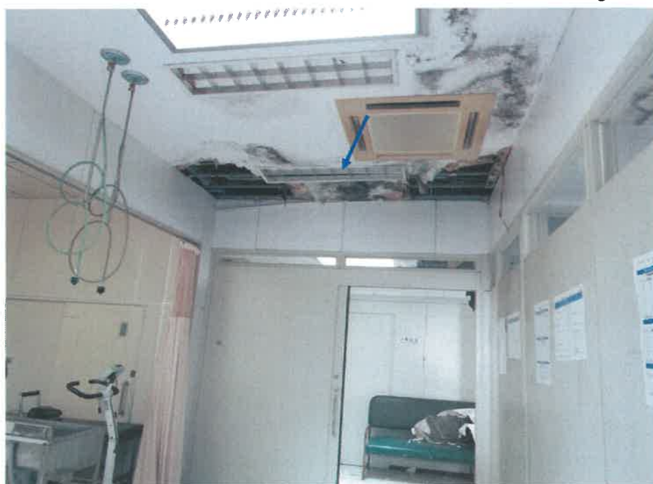
雨漏り跡の様子
