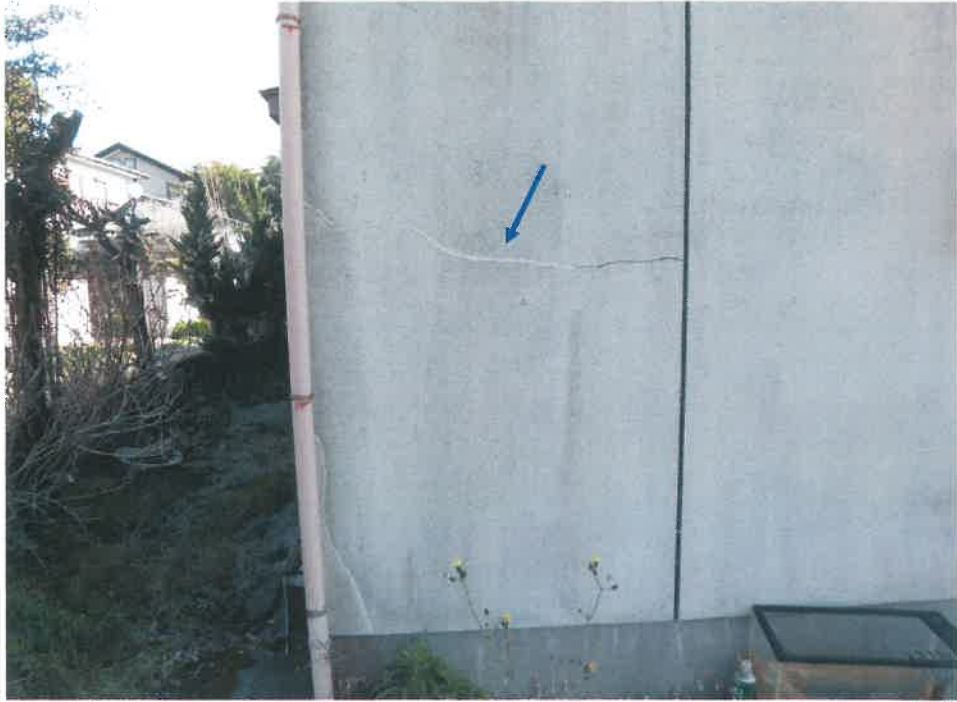
外壁のヒビの様子
