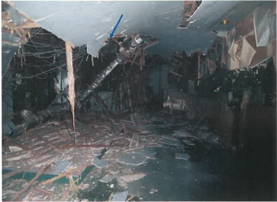
天井の破損の様子
