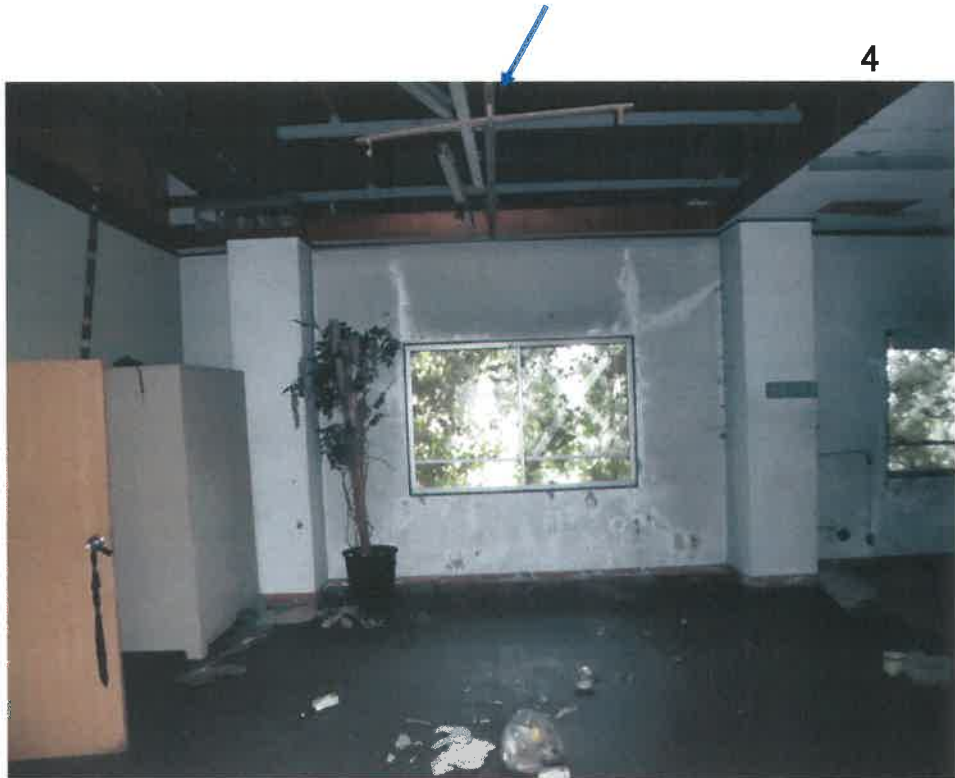
天井の破損の様子
