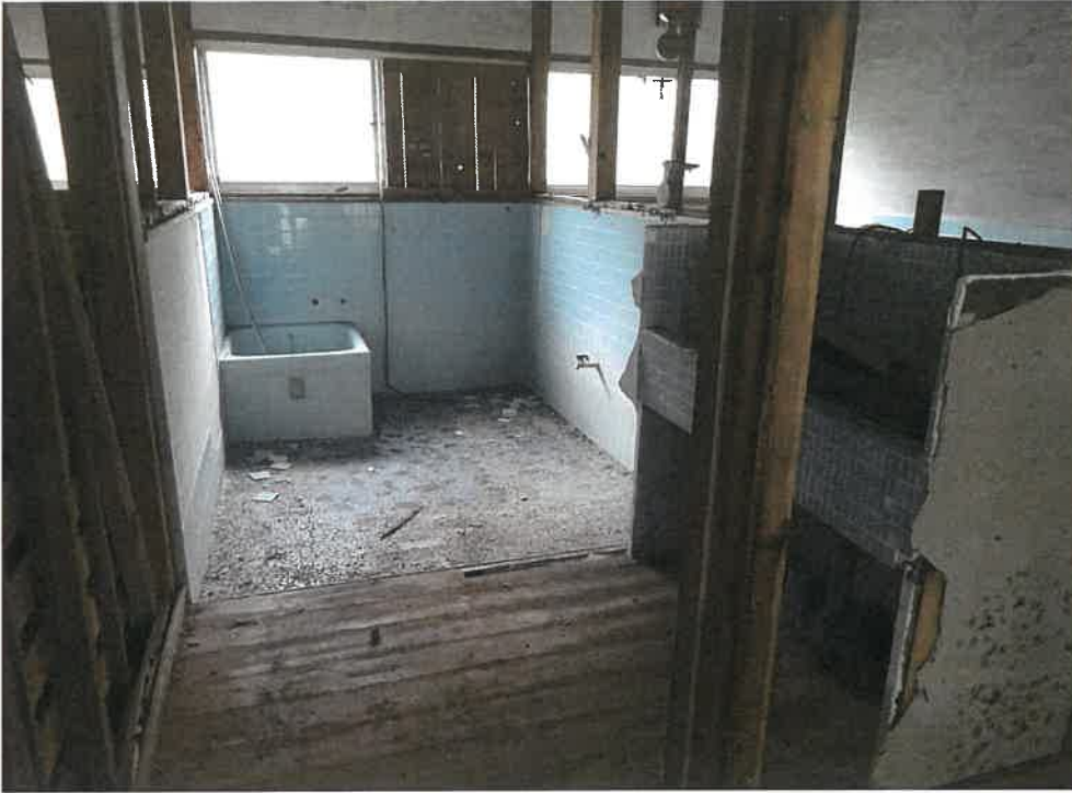
写真22 天井材の損傷
