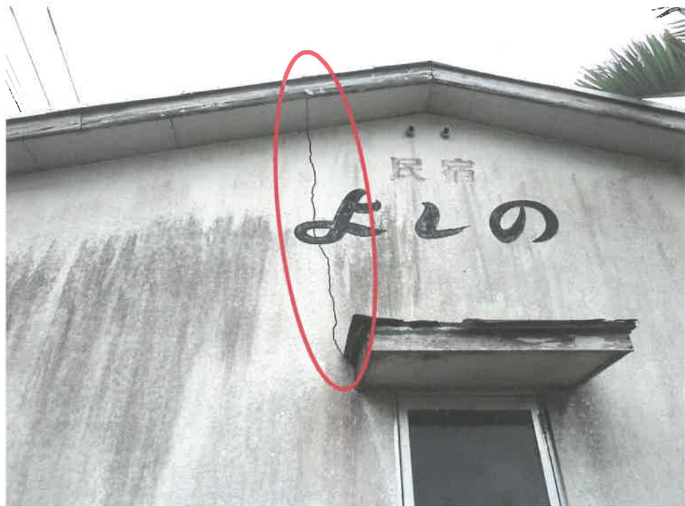
物件4 外壁のひび割れ
