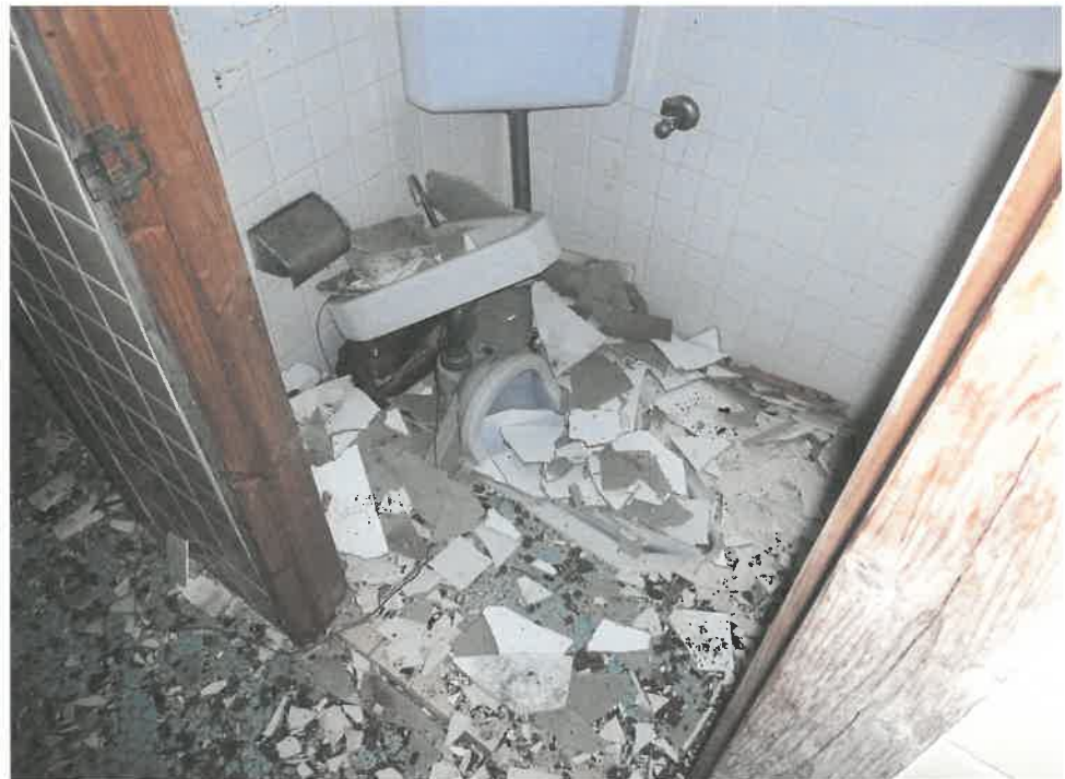
物件4 トイレ破損状況
