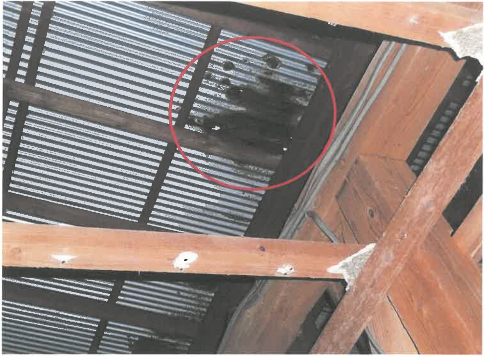
物件 4 屋根腐食状況
