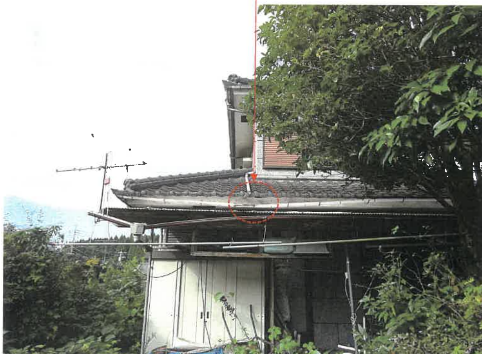
雨樋の破損箇所
