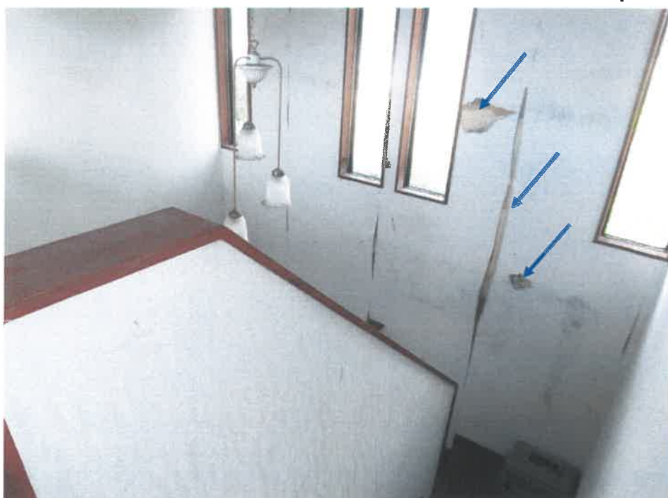
クロスの剥がれ、内壁の破損の様子
