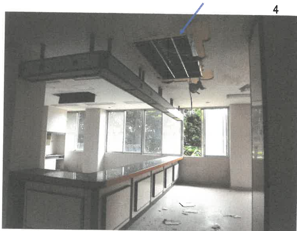
天井破損の様子
