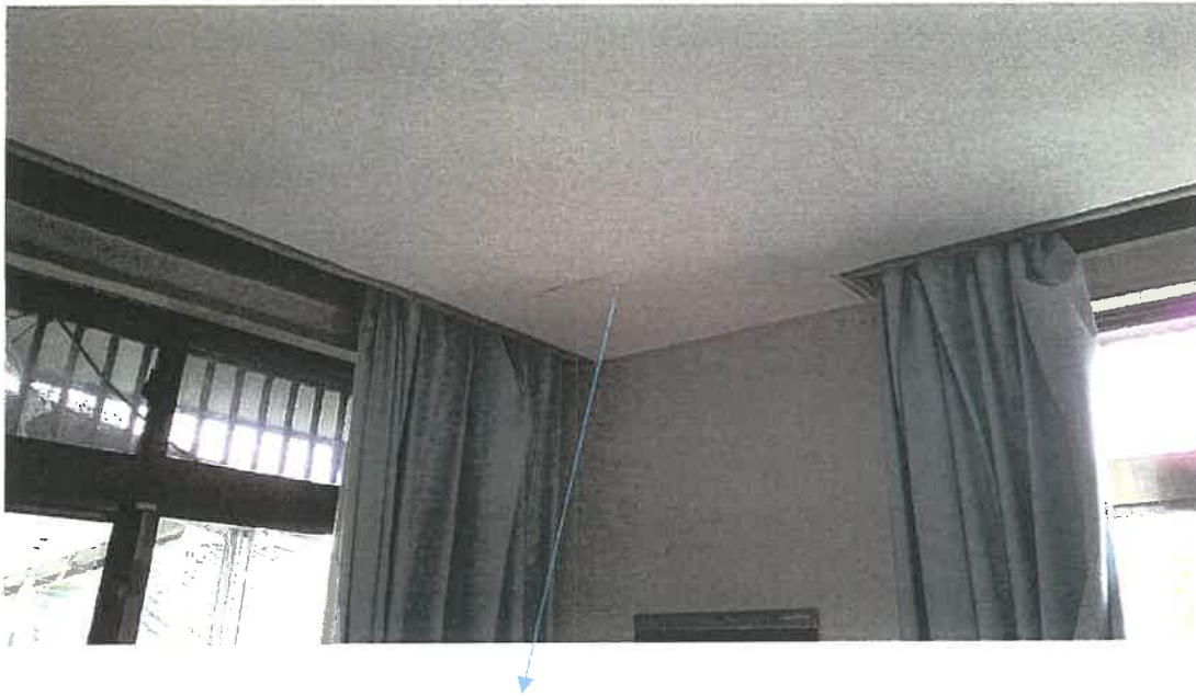
雨漏りの影響
