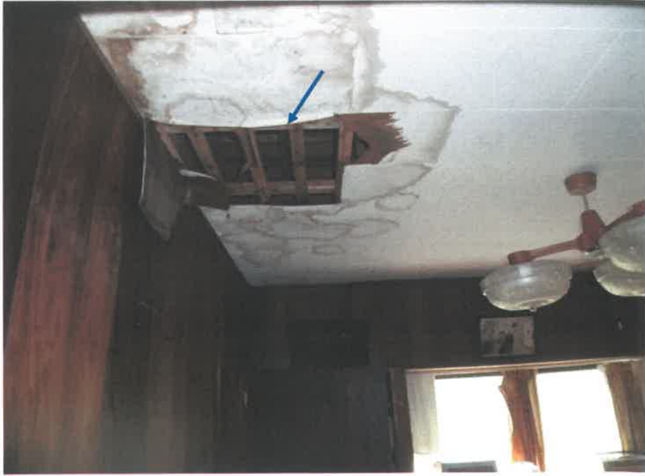
雨漏り跡の様子
