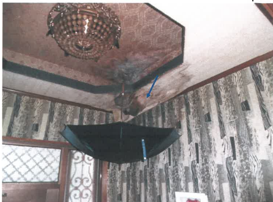
雨漏り跡の様子
