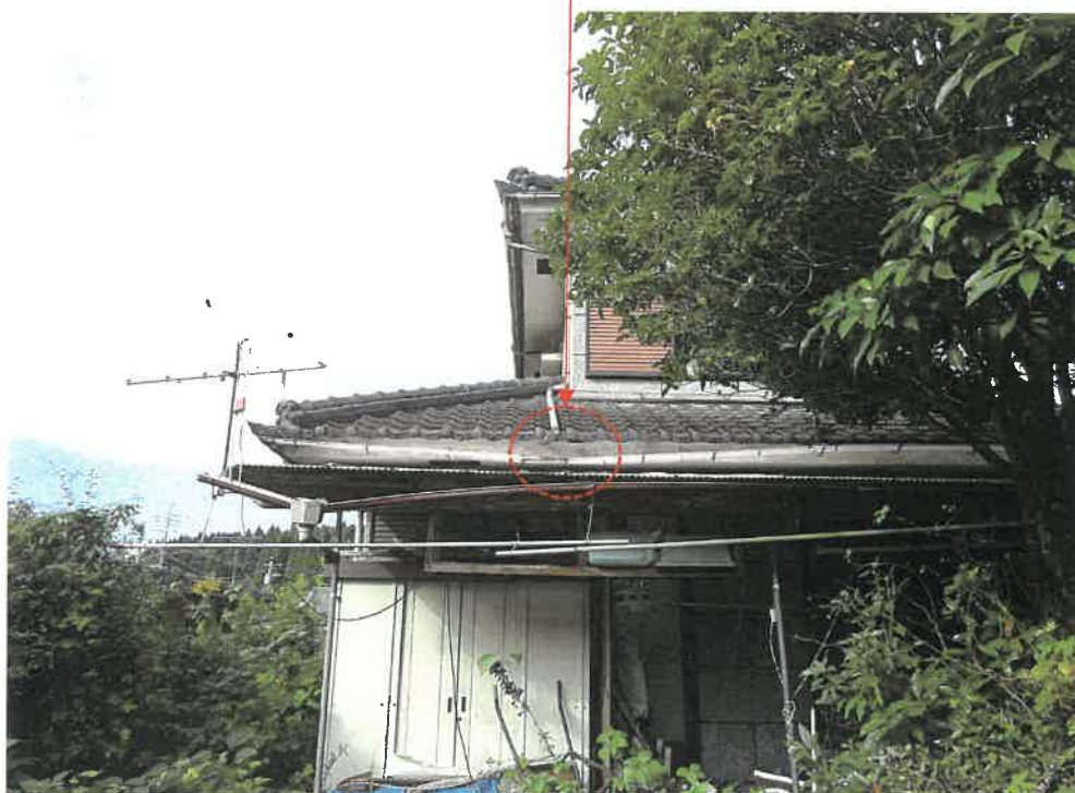
雨樋の破損箇所
