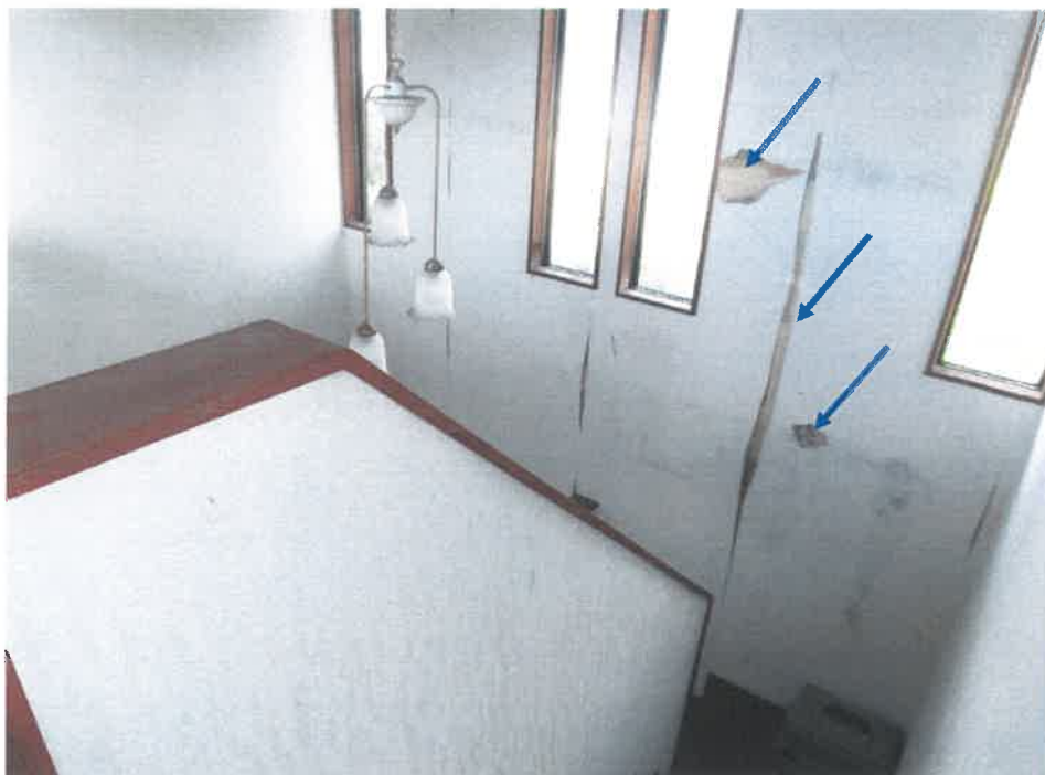
クロスの剥がれ、内壁の破損の様子
