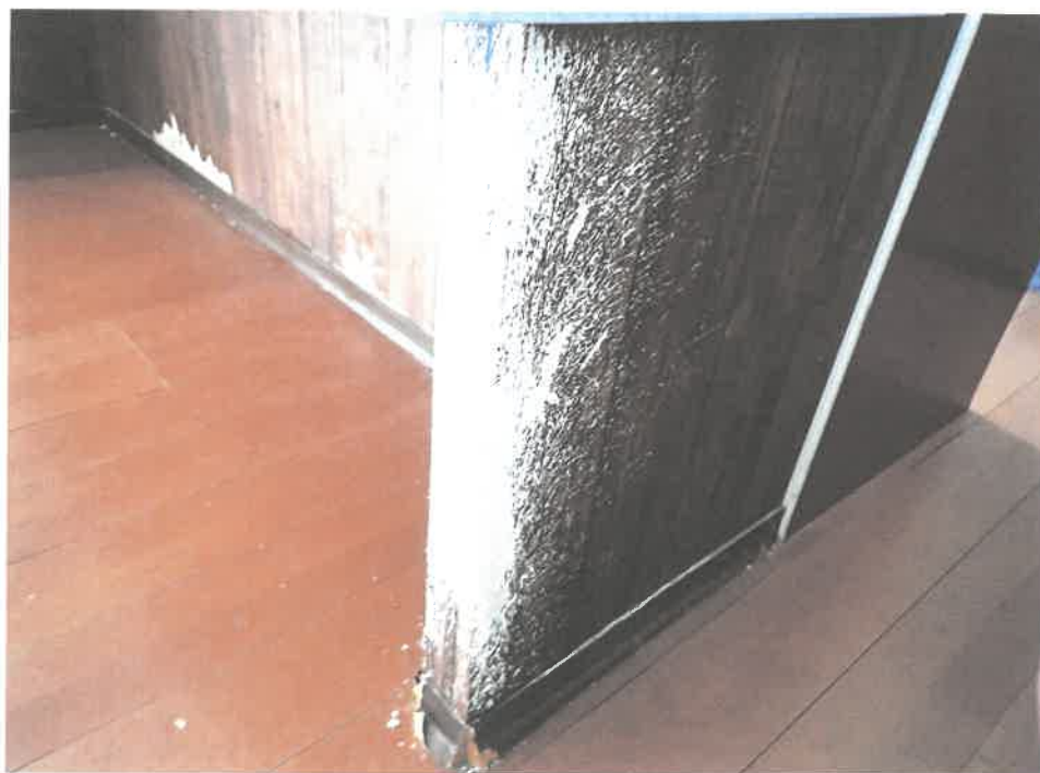
物件3 建物内部のひっかき傷
