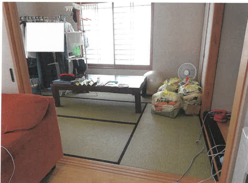
写真10 リビング出入口用建具の破損
