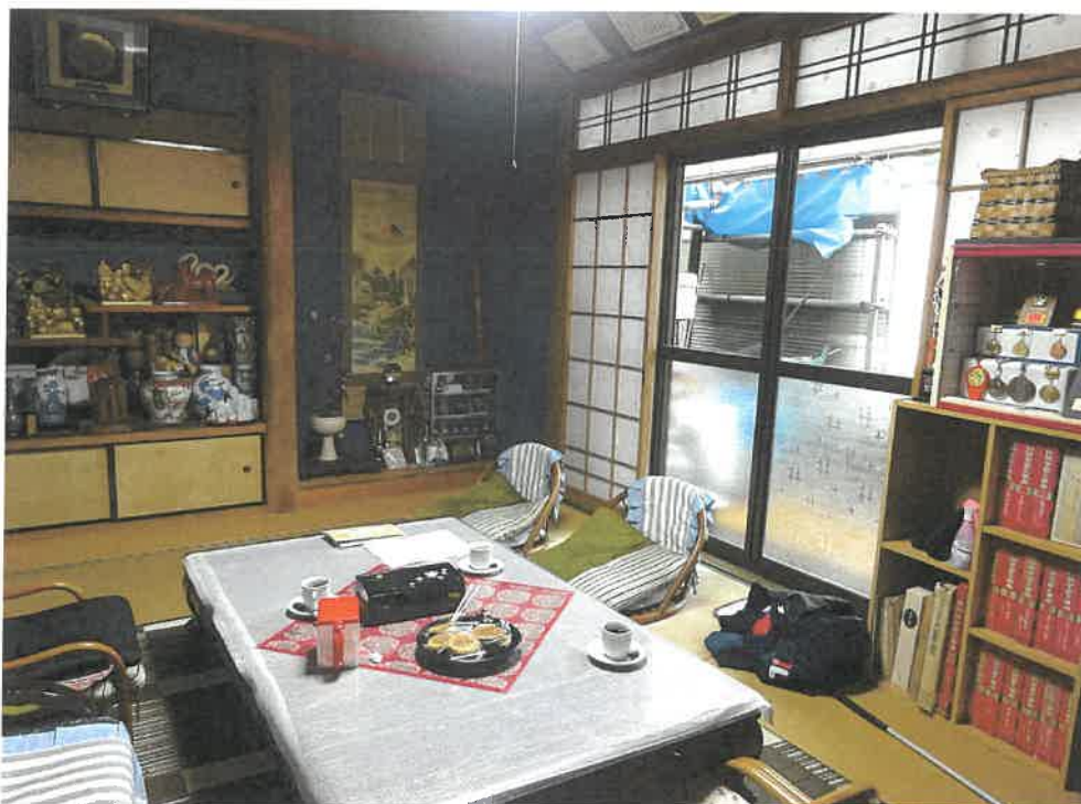
写真6 床の沈み込みを感じた箇所
