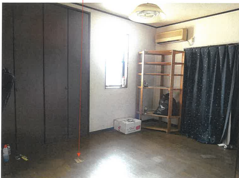
フローリングの傷み
