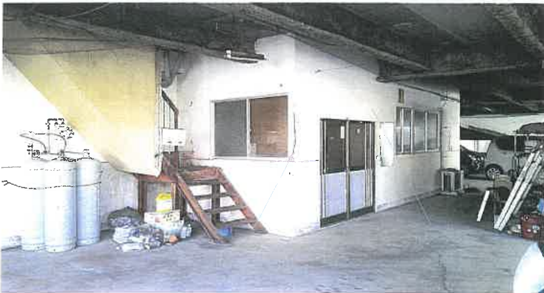
ヒビ割れ箇所
