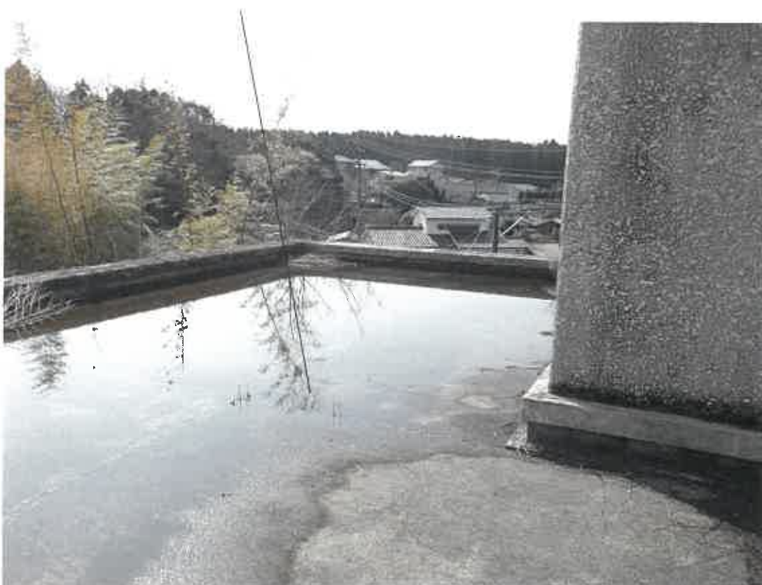
本件建物の屋上部分に雨水が溜まった状況
