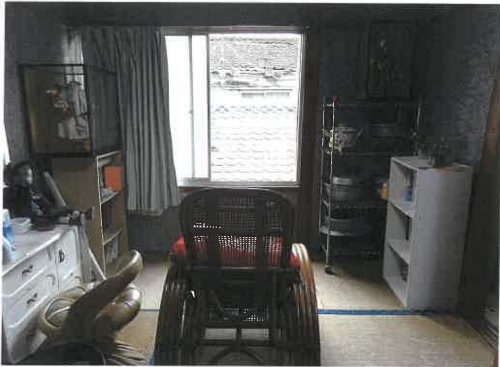
写真14 天井板の歪み
