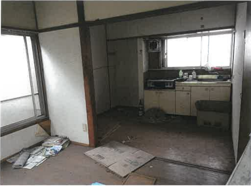
写真12 天井板の黒ずみ
