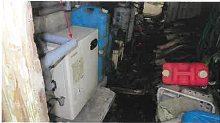
灯油ボイラー
