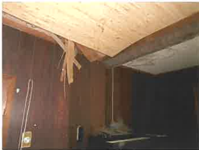
物件 2・1 階天井破損、雨漏り痕
