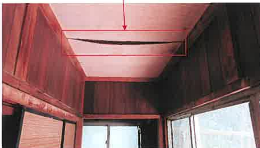
(写真 24 ) 天井の損傷
