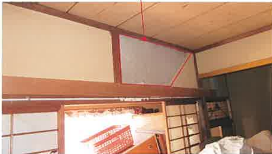
内壁損傷（崩落）
