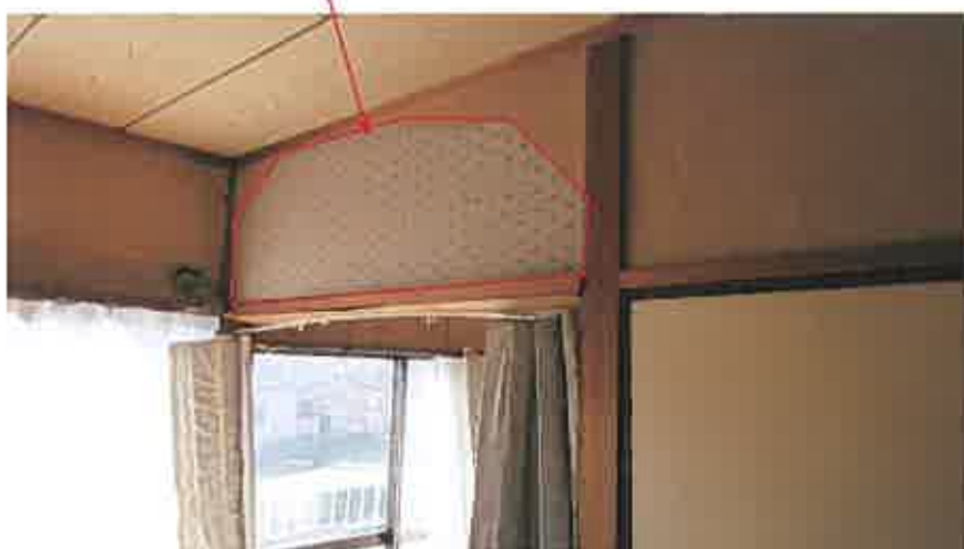
内壁損傷（崩落）
