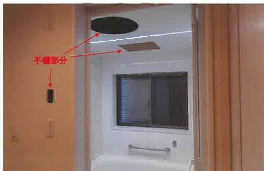
物件4 (浴室乾燥機の不備)
