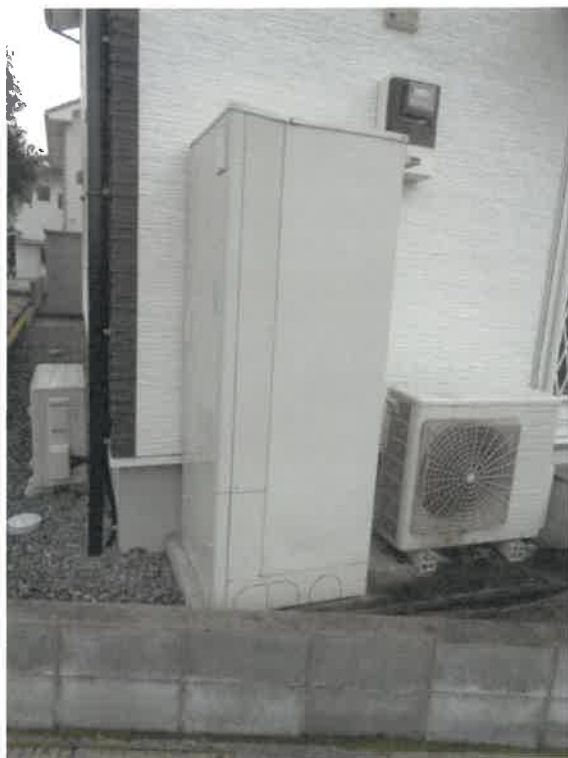
(写真3) ヒートポンプ式給湯器
