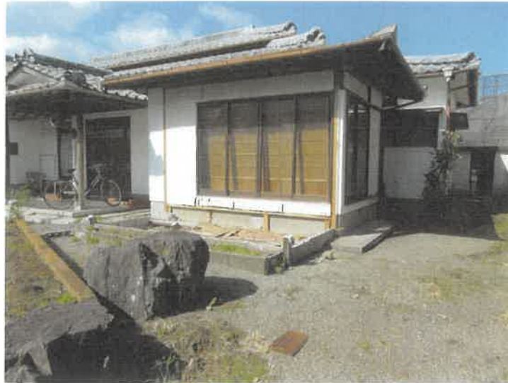
写真②壊されたサンルーム部分
