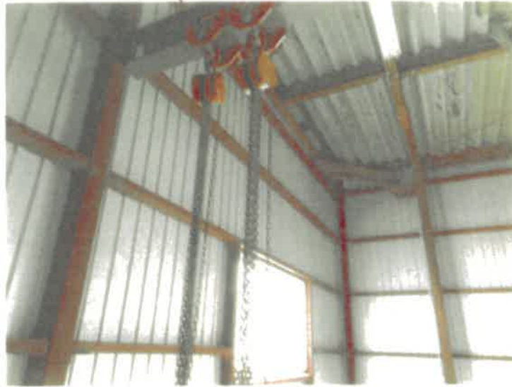
写真①⑨ ギヤードトロリー 2 台
