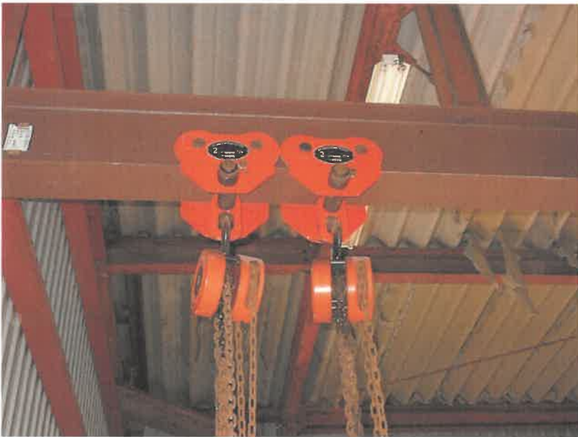
物件 6 工場内の機械器具
