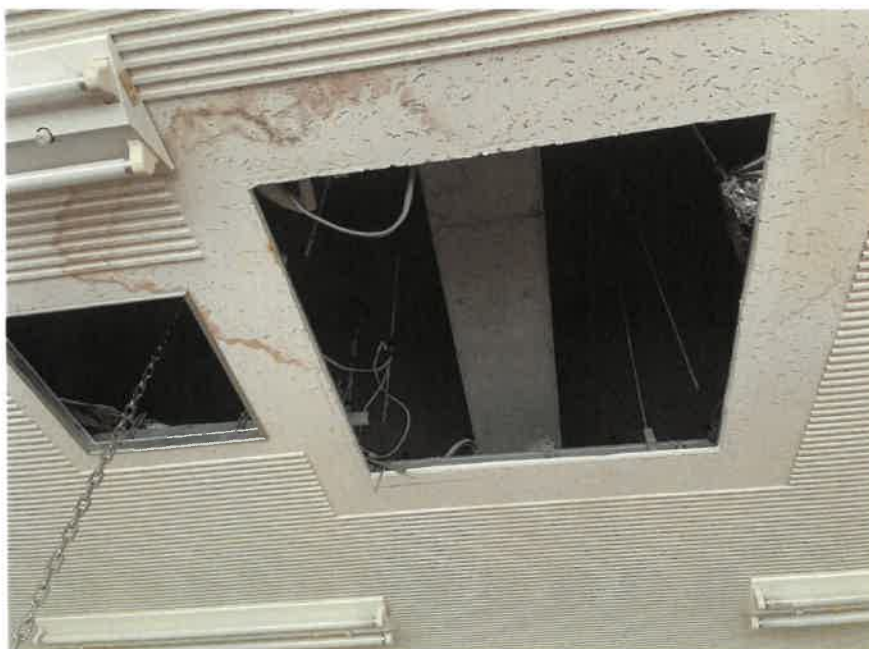
物件 4 汚損の状況 3階事務所 天井の一部切り取り・雨染み
