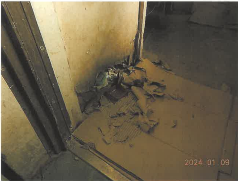
物件 5 内壁の破損
