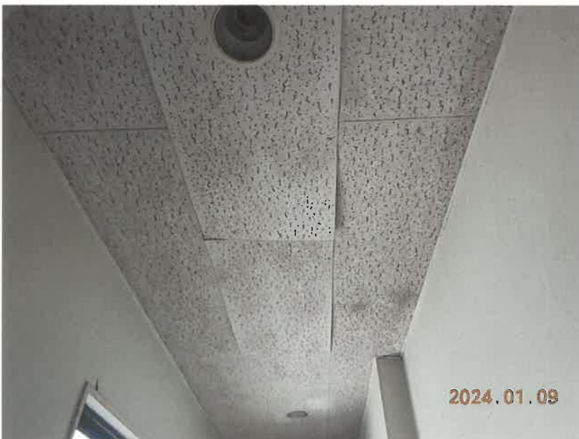
物件 5 天井部分の雨漏り (カビ)
