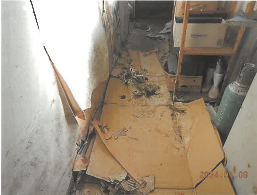
物件 5 内壁の破損
