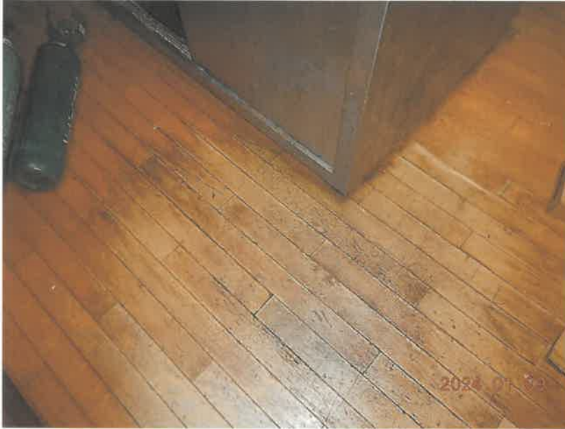
物件 5 床の劣化
