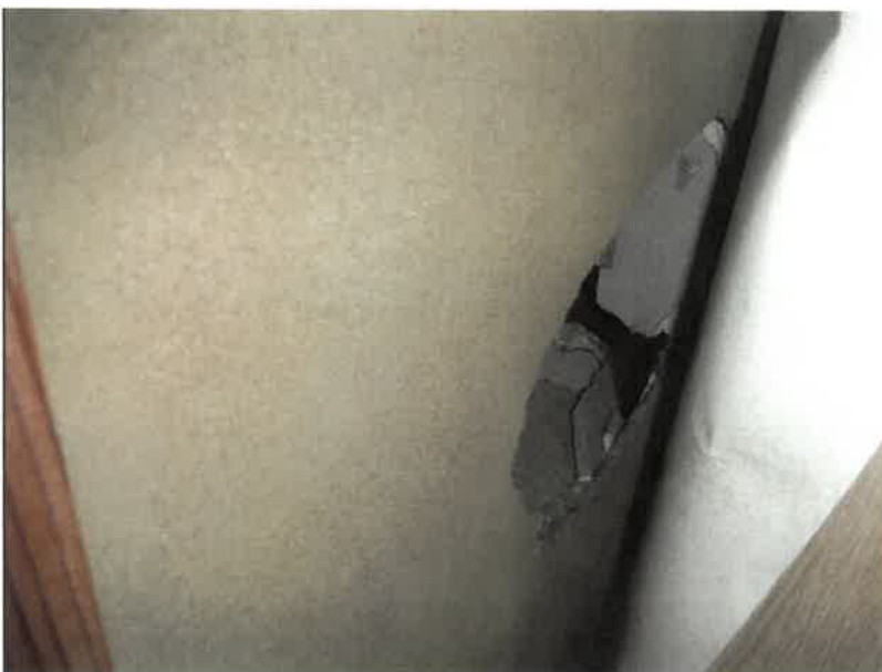
No. 3 物件 2 (2階・内壁)
