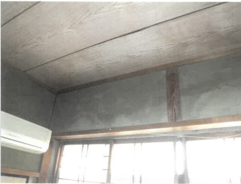
No. 2 物件 2 (2階・内壁)
